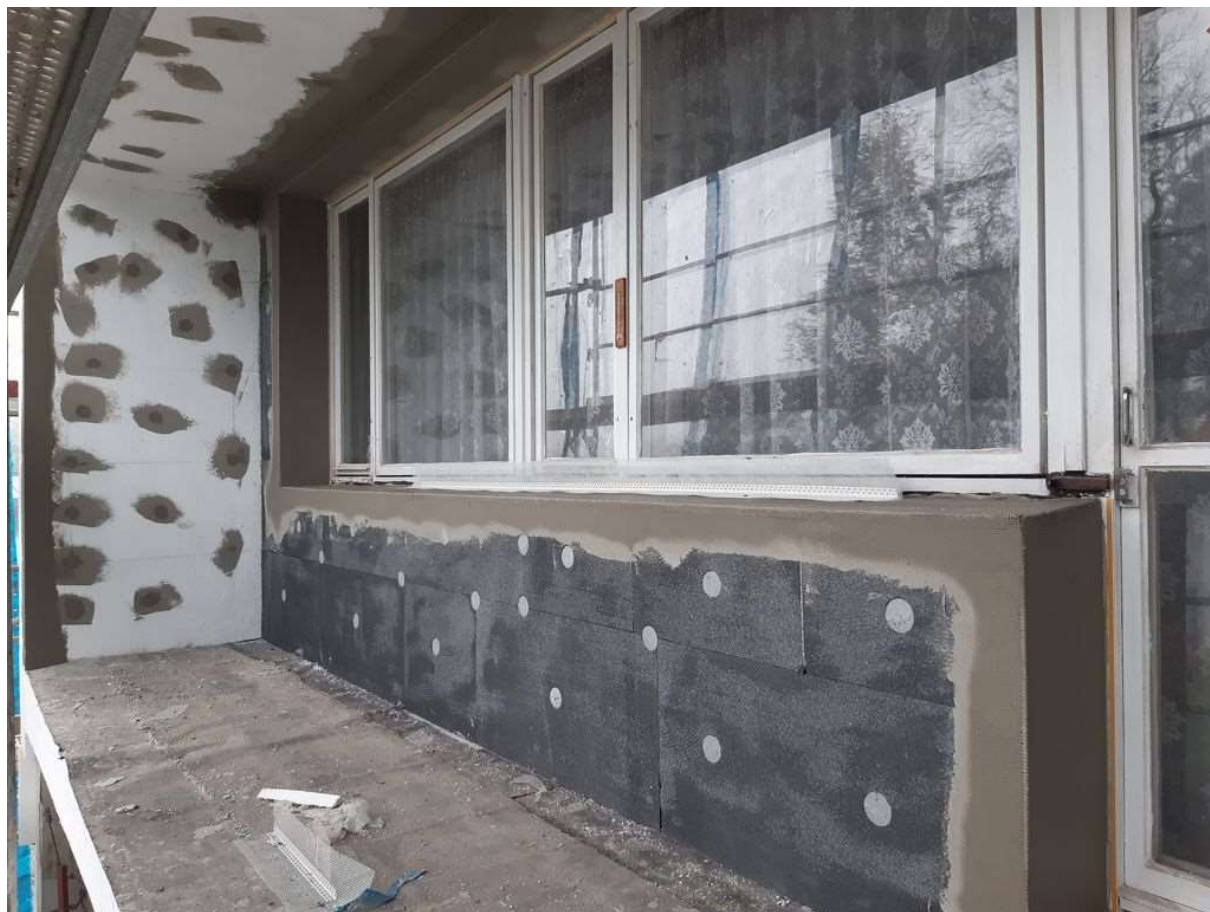
Foto č. 3: Vnější kontaktní zateplovací systém (ETICS) – šedý a bílý fasádní polystyrén
